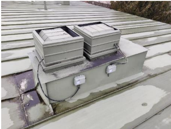
Kuva 63. Poistoilman huippumureita vesikatolla.
