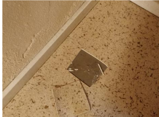
Kuva 23: Askarteluhuoneen muovimatonäytteessä MNVO5 ei havaittu poikkeavia VOC-yhdisteitä tai niiden pitoisuuksia.
