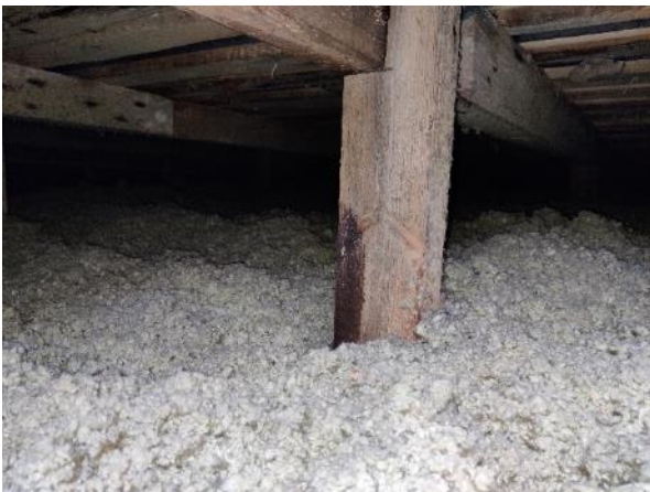
Kuva 40: Palopermannon päällä on puhallusvillaeriste.
