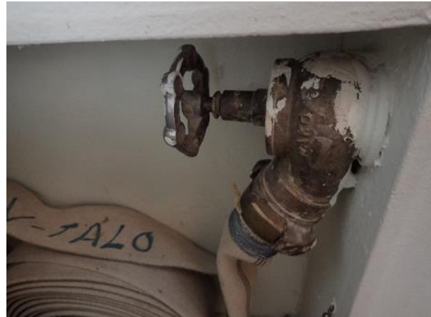
Kuva 70. Alkuperäinen sulkuventtiili ja muotonsa menettänyt paloletku.
