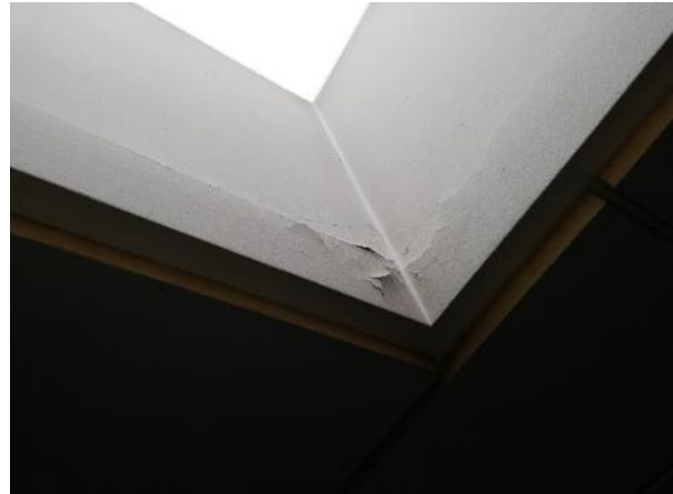
Kuva 43: Kosteusvauriojälkiä kattoikkunan alareunassa.
