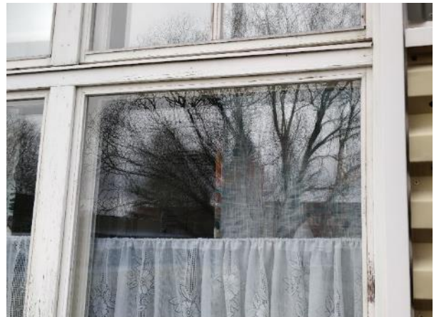
Kuva 9: Ikkunoiden puosat ovat paikoittain huonossa kunnossa.
