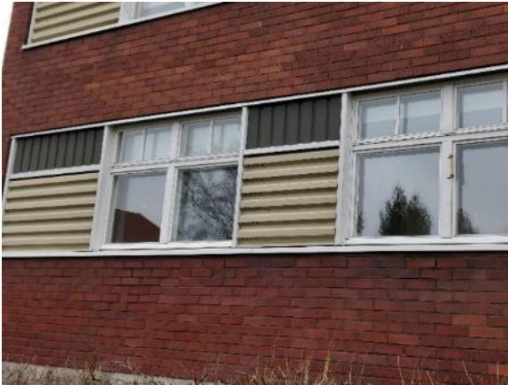
Kuva 26: Pellitykset ikkunoiden kohdalla.
