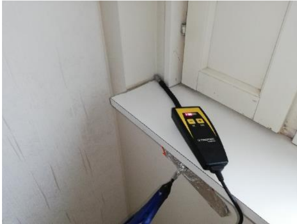
Kuva 34: Ikkunaliittymät ovat epätiivittä.
