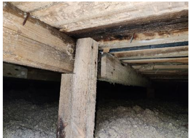
Kuva 41: Yläpohjan puurakenteissa on havaittavissa kosteusvaurioita.
