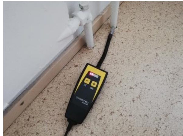
Kuva 19: Alapohjan läpiviennit ovat epätiivaitä.
