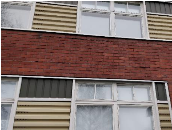
Kuva 24: Rapautumista tiilijulkisivun saumoissa.
