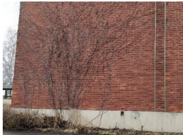
Kuva 3: Ulkoseinää pitkin kasvaa köynnöskasvi.
