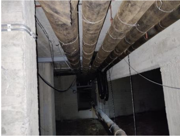
Kuva 49. Tervapaperipintaisia villaeristeisiä lämmitys- ja vesijohtoja tuulettuvassa alapohjatilassa.
