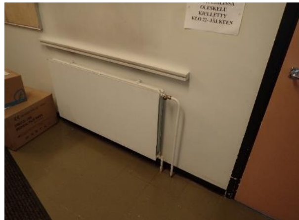
Kuva 52. Alkuperäinen teräslevypatteri ja patteriventtiili, jonka termostaatti on irronnut.
