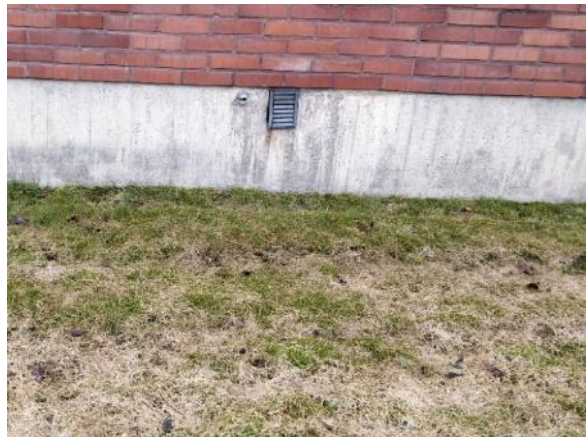
Kuva 29: Julkisivun tuulettuvuus on heikko.
