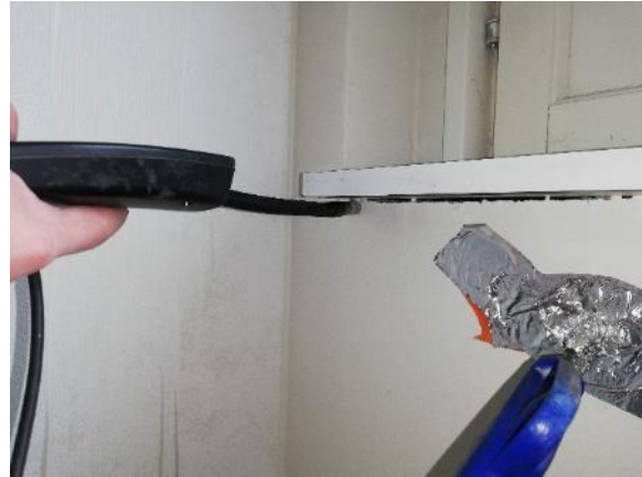
Kuva 35: Ikkunaliittymät ovat epätiivittä.
