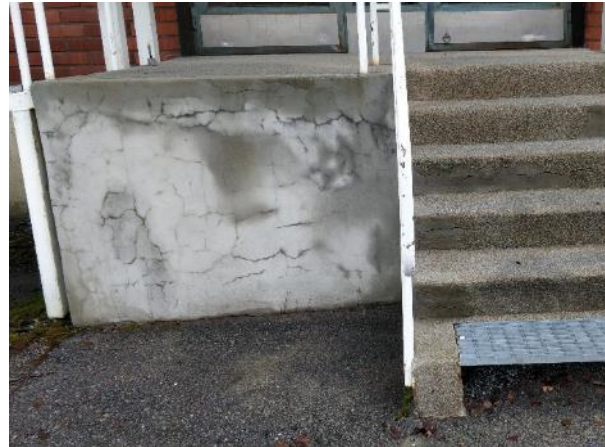
Kuva 5: Asuinrakennusten sisäänkäyntitasot olivat huonokuntoiset ja betonirakenne on rapautunut.
