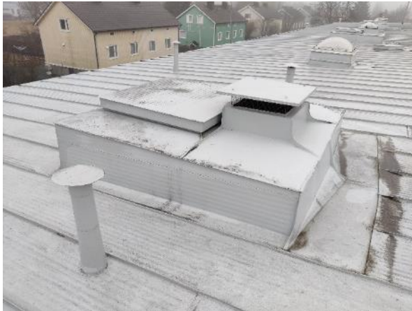
Kuva 61. Poistoilmamuurin kammio vesikatolla.
