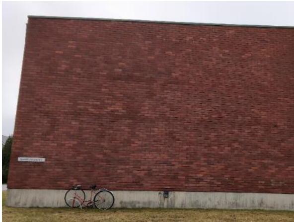
Kuva 4: Sokkelissa oli havaittavissa kosteusvauriojälkiä.
