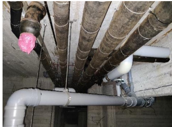
Kuva 54. Tuulettuvassa alapohjatilassa havaittiin tervapaperipintaisia, villalla eristettyjä alkuperäisiä vesijohtoja.
