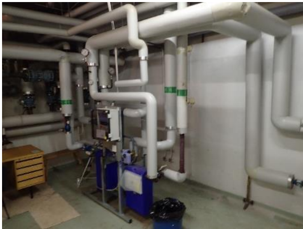
Kuva 47. Kaukolämmön alajakokeskus on vuodelta 2013.
