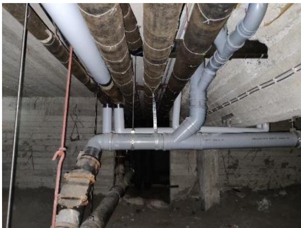
Kuva 57. Muoviputkella saneerattuja jätevesiviemäreitä tuulettuvassa alapohjassa.
