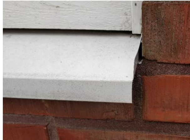
Kuva 11: Ikkunoiden pellityksen seinäliittymät ovat epätiivit.
