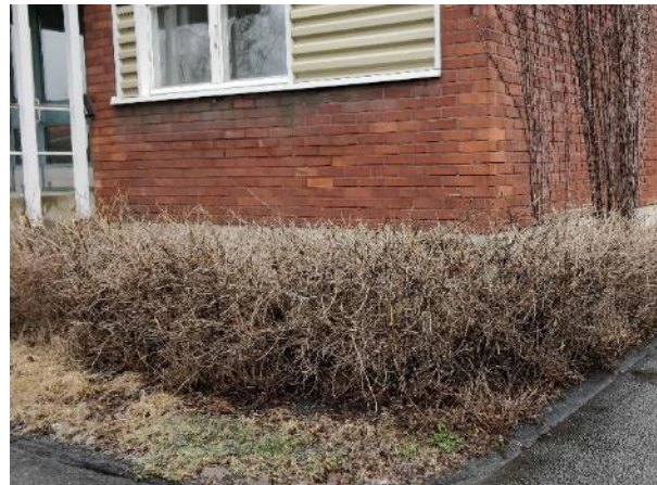
Kuva 25: Kosteusjälkiä tiilijulkisivussa ikkunan alapuolella.
