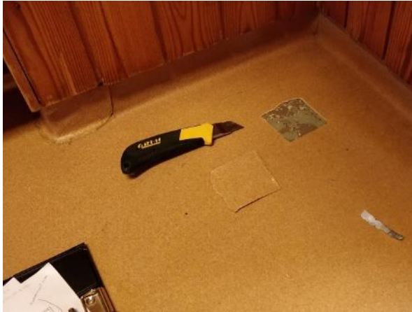
Kuva 22: Pukuhuoneen muovimatonäytteessä MNVO6 ei havaittu poikkeavia VOC-yhdisteitä tai niiden pitoisuuksia.
